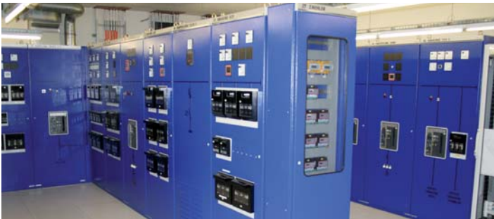
Elektrische Installation der NürnbergMesse
