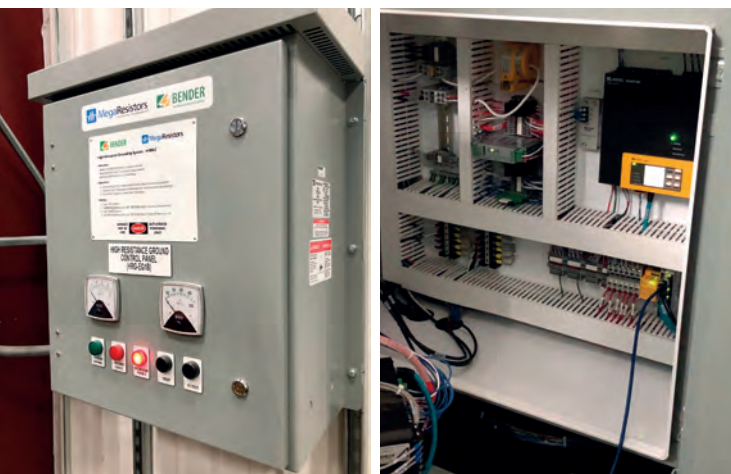
Wandmontiertes hochohmiges Erdungspaket der Bender Serie 1 zum Schutz der Generatoren
