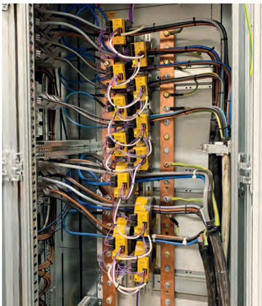
SensorPro-Differenzstrom-Überwachung mit RCMB301-Modulen an den Abgängen der Hauptverteilung
