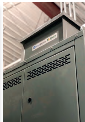
Bender/Megaresistor-Neutralerdungswiderstand über der Schaltanlage montiert
