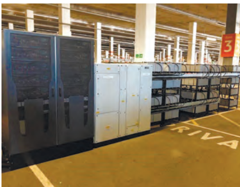
Bender UK liefert 600 kVA modulare USV-Energieinfrastruktur an das NHS Nightingale Hospital, ExCel Center, London
